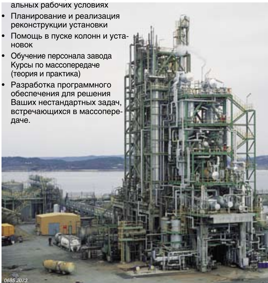
Установка по производству аминов Колонны оборудованы регулярной насадкой Зульцер
